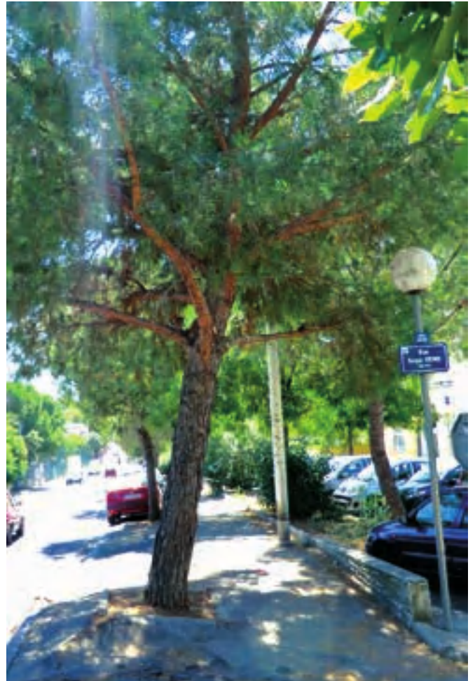
PIN SOULEVANT LE TROTTOIR, QUARTIER ANTIGONE
