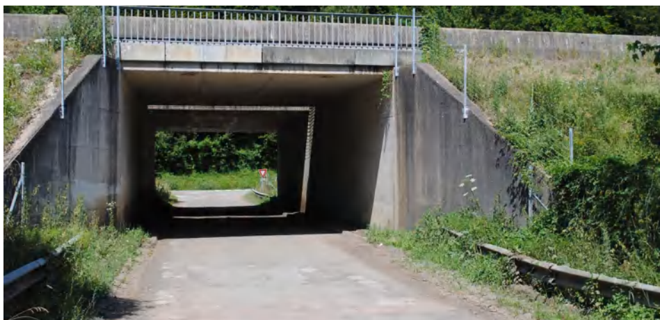
Franchissement routier inférieur de l'A36 avec un environnement perméable à la faune à conserver. (image : Déforêt T.)
