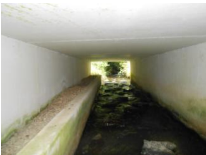
Banquette pour passage à loutre, avec aménagements pour ralentir le débit (source Biotope)
