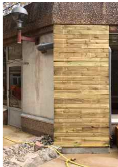
Récupérateur d'eau recouvert d'un bardage bois à l'école Emeriau
