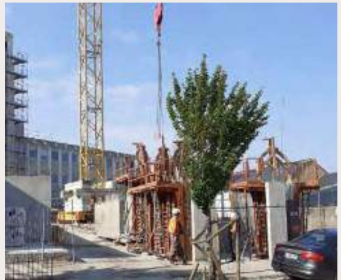
Sur la photo du haut (avant travaux), l'arbre de gauche a été supprimé pour créer l'accès charretier en phase travaux.
