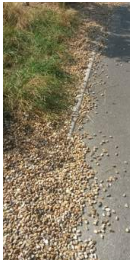
Exemple de mauvaise adéquation entre choix de bordure, usage et nature du revêtement (© P&C – Robin Dagois)
