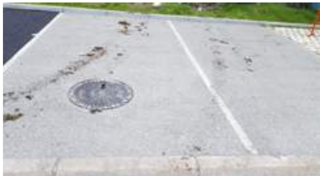
Exemple de risque de colmatage précoce dû au déplacement de remblais sur un revêtement perméable (© Wendy Arnould, Orléans)
