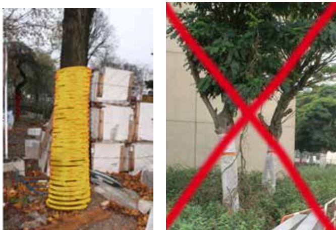
Illustration 4 : Protection des troncs avec du drain annelé perforé (pour les petites circonférences jusqu'à 45cm)
