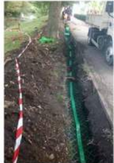
Implantation de réseaux sous les arbres. La tranchée altère de nombreuses racines
