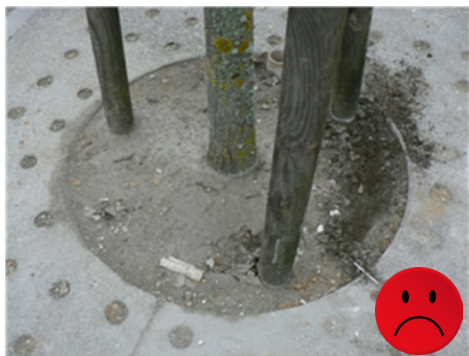
Photo 11 : Ici, le pied de cet arbre a servi de dépôt de laitance de béton, polluant le sol et toxique pour l'arbre.
