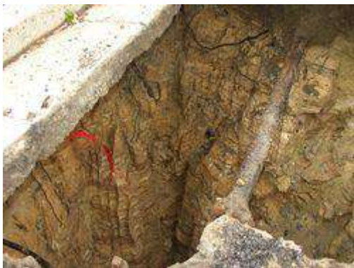
Dissolution du gypse suite à une fuite de réseau, dans le Val-d'Oise © CEREMA DTER IF
