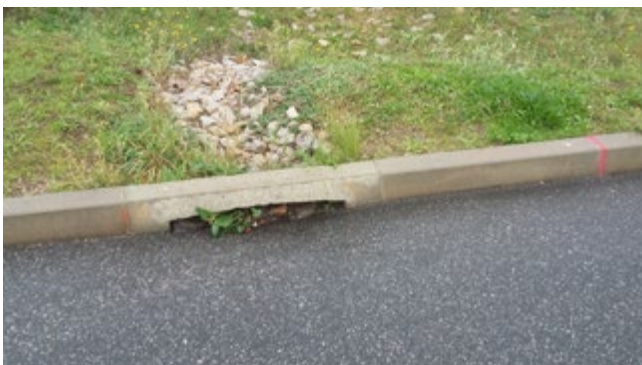
Bouches d'alimentation permettant de diriger les eaux pluviales du parking vers la noue. / Robin Dagois, Plante & Cité
