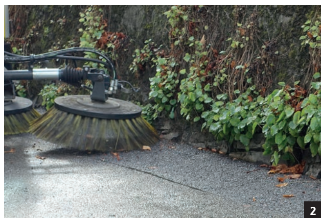
1 - Un propriétaire de mur privé ôte manuellement mousses, lichens, Polypodes et autres Pariétaires de Judée. 2 - Les brosses de la balayeuse qui passent régulièrement ont petit à petit rongé les joints sur le bas du mur. Au-dessus, les joints sont encore en très bon état malgré un recouvrement important par la végétation. Rampe de la treille, Genève (Suisse). I © Sandrine LARRAMENDY
