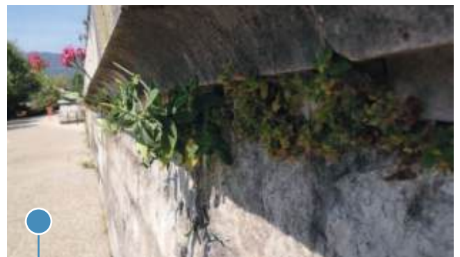
Berges de l'Isère à Grenoble. Développement de la Centranthe rouge ou valériane ( Centranthus ruber ) dans les fentes d'un mur. Source : AURG, 2019
