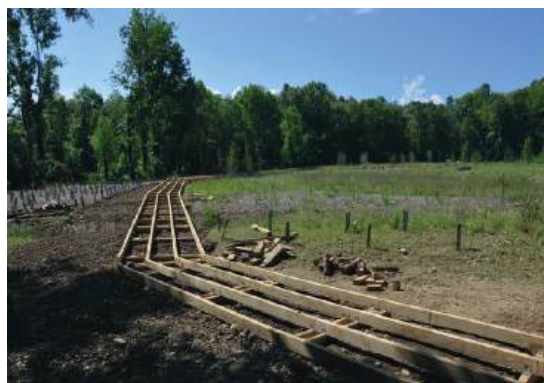
La passerelle dans la zone nature, lors de sa construction en mai 2022
