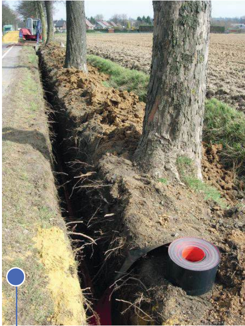
Alignement d'arbres gravement atteints après le creusement d'une tranchée Source : ApiTrees, 2020
