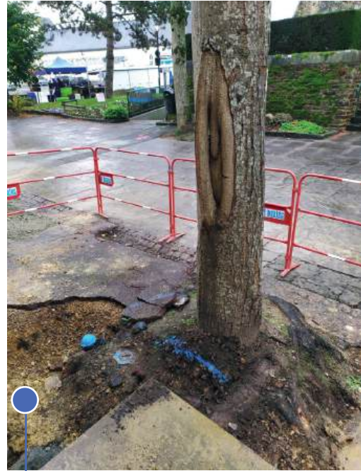
Travaux de voiries et réseaux divers (VRD) effectués trop près de l'arbre qui a déjà subi une dégradation au tronc - Source : Cambios
